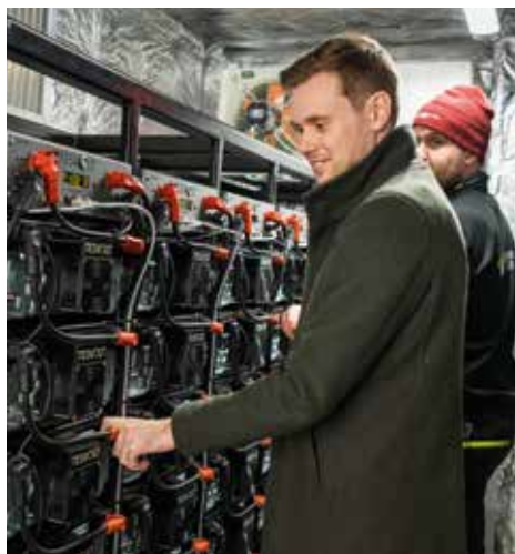
Kverneland Energi har spesialisert seg på store, mobile, batteripakker til bruk på blant annet byggeplasser. Her blir en av battericontainerne inspisert av Jonas Kverneland og Henrik Due.
